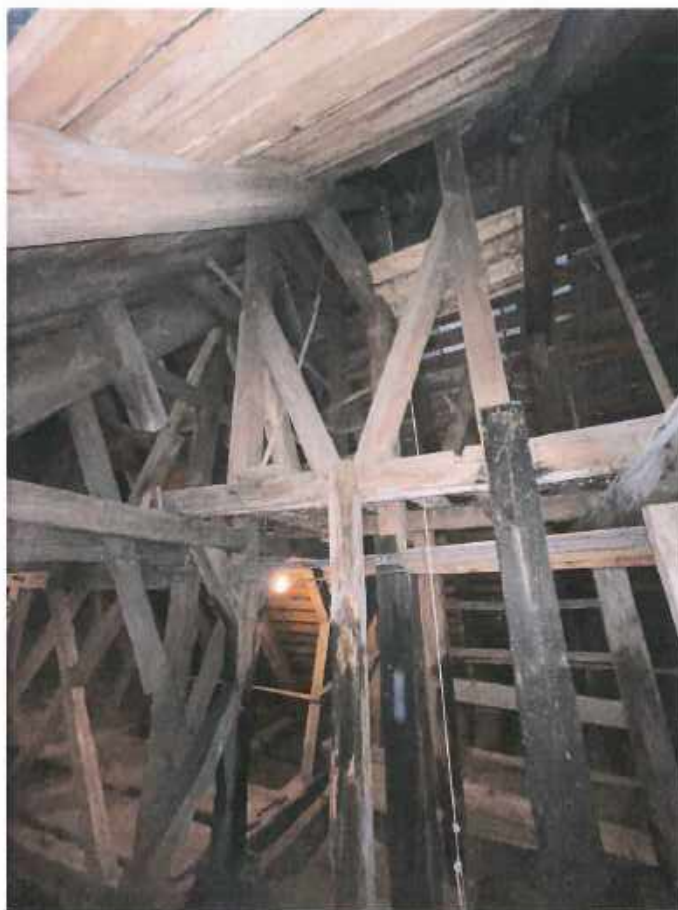
Fotografia 2. Konstrukcja nad nawą w obrębie wieży sygnaturki. Stan drewna zły, widoczna wyraźna destrukcja drewna, przeróbki (wycięte elementy konstrukcji), wzmocnienia nakładkowe z desek.
