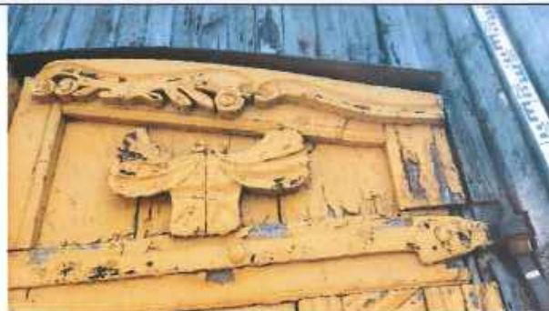
Rysunek 22. Widoczny sposób mocowania zawiasu skrzydła drzwiowego do ściany kościoła. Widoczny fragment zdobień zewnętrznych skrzydła drzwiowego, złuszczonej farby.
