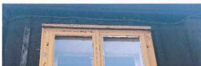
Rysunek 8. Widoczny okapnik górny okna O2.
