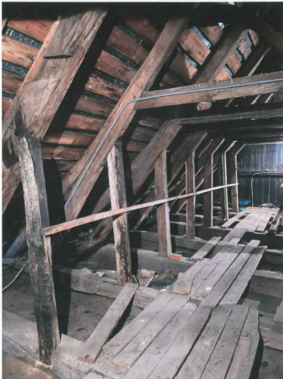
Fotografia 12. Konstrukcja dachowa nad korpusem kościoła – widok ogólny (widoczne braki w elementach konstrukcyjnych oraz przewężenia po ataku owadów szczególnie w okolicy słupów)
