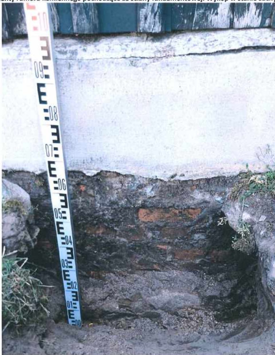
Fotografia 3. Odkrywka fundamentów nr 2 przy kaplicy bocznej od strony wejścia głównego. Głębokość posadowienia, widoczne warstwy ścianki fundamentowej z cegły ceramicznej a w niższych warstwach z kamienia. Górna część fundamentu otynkowana w latach 90-tych, brak izolacji poziomej i pionowej.
