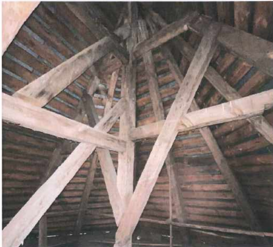
Fotografia 15. Konstrukcja dachowa nad prezbiterium – widoczne zawilgocenia, zdegradowane elementy konstrukcyjne oraz braki niektórych elementów konstrukcyjnych
