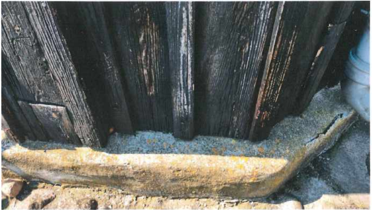
Fotografia 19. Widok części elewacji wschodniej kościoła w Umieniu – zmuszałe końcówki deskowań, widoczne fragmentaryczne wymiany końcówek
