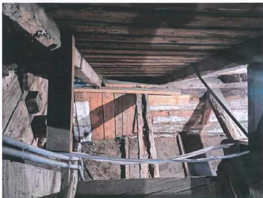
Fotografia 9. Widok na elementy konstrukcyjne belek stropowych nad zakrystią – widoczne przegnie przekroje elementów konstrukcyjnych
