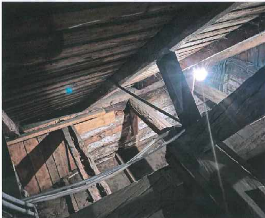
Fotografia 10. Widok na elementy konstrukcyjne belek stropowych nad zakrystią – widoczne przęgnite przekroje elementów konstrukcyjnych oraz przęgnite ściany zakrystii, na których opierają się belki stropowe. Widoczne naprawy i elementy wtórne
