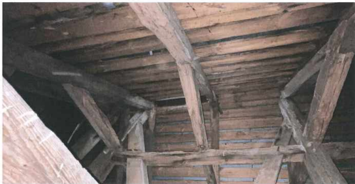
Fotografia 6. Konstrukcja płatwi górnej oraz zawilgocone krokwie w obrębie kalenicy, destrukcja biologiczna. Stan techniczny zły, widoczne ubytki na powierzchni.
