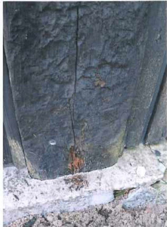
Fotografia 22. Widok części lisicy kościoła w Umieniu – brak izolacji pomiędzy drewnem a zaprawą cementowo-wapienną. Element obmurowany, co skutkuje destrukcją drewna.
