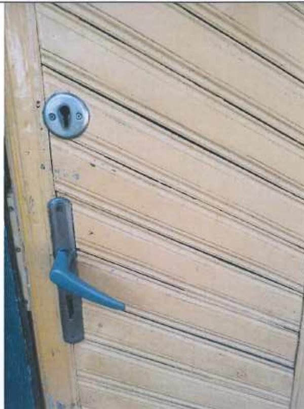
Rysunek 36. Widoczna klamka drzwi zewnętrznych do zakrystii
