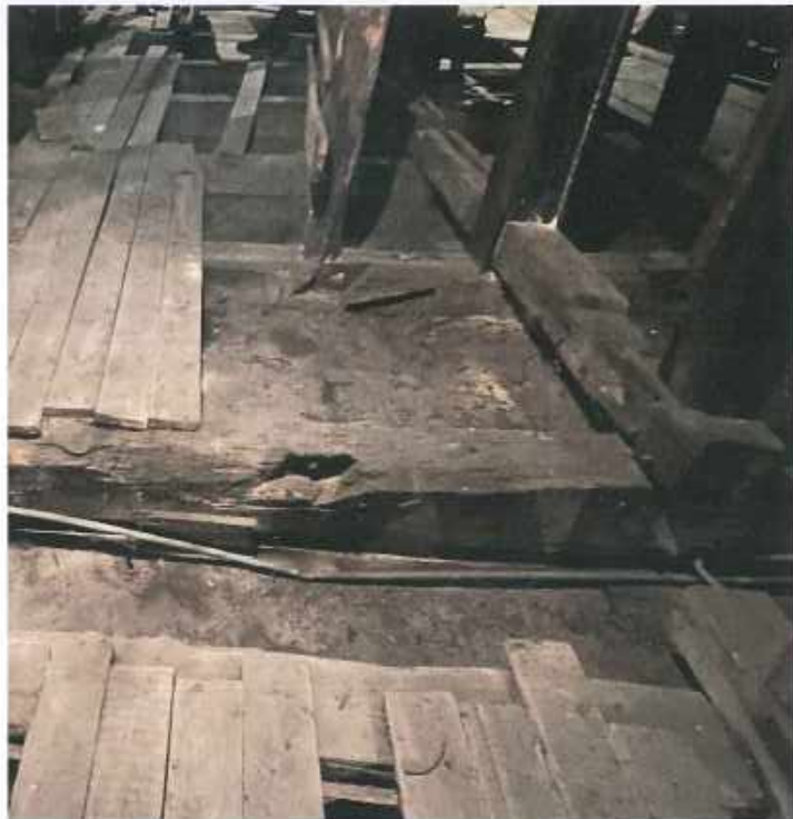
Fotografia 3. Belki stropowe nad prezbiterium i nad nawą. Stan drewna zły, widoczna wyraźna destrukcja drewna, przeróbki, wzmocnienia nakładkowe z desek.
