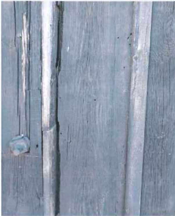
Fotografia 21. Widok oblicówki zewnętrznej kościoła w Umieniu -w widoczne ślady po owadach, mocno zdegradowana część oblicówki na połączeniu desek
