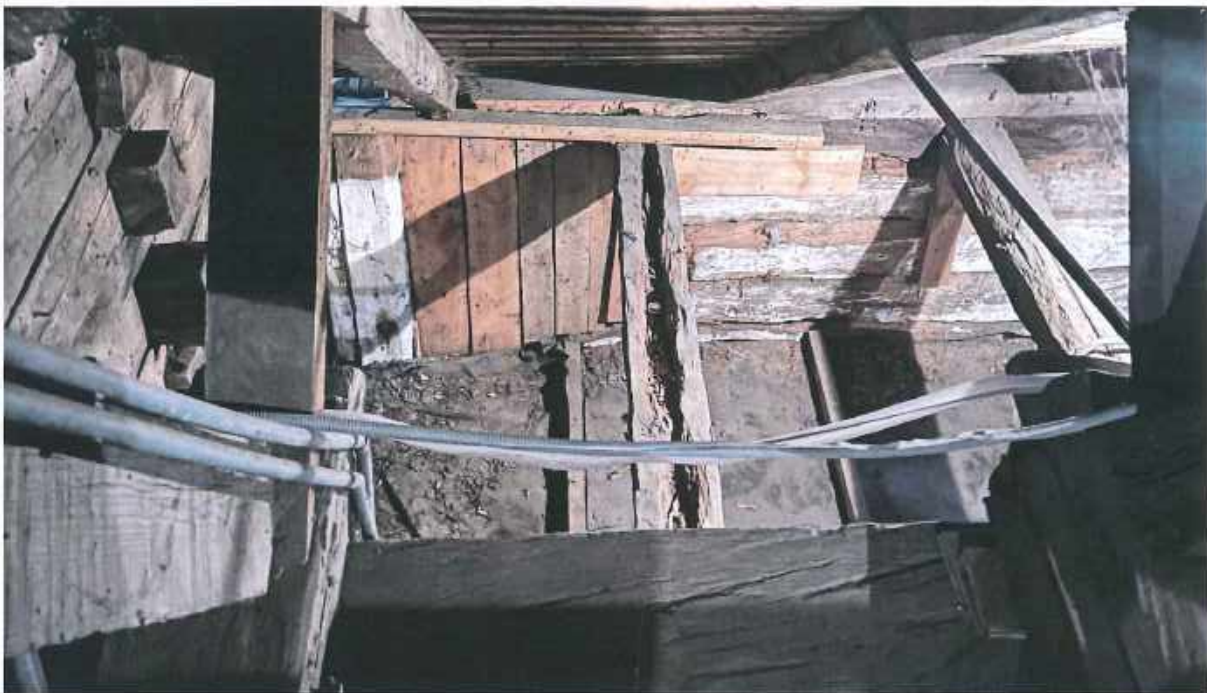
Fotografia 4. Belka stropowa (nad zakrystią) stan drewna zły, widoczne wyraźne spróchnienie drewna, element całkowicie zniszczony, nie spełnia swojej funkcji.
