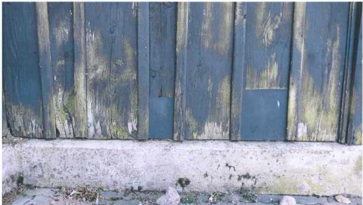
Fotografia 23. Widok części elewacji północnej kościoła w Umieniu – zmurszałe końcówki deskowań, widoczne wykwyty i zagrzybienie, deski zaatakowane przez mchy i porosty
