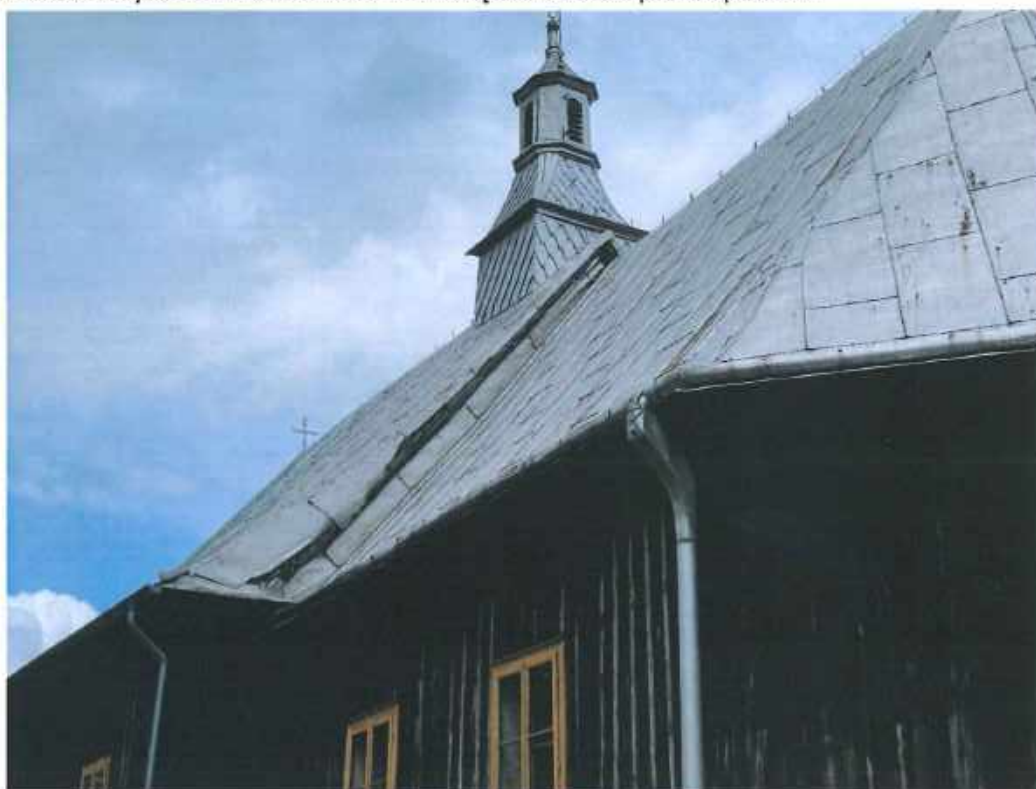
Fotografia 17. Widok połaci dachu nad prezbiterium, nawą główną oraz sygnaturką – widoczny sposób wykonania kosza pomiędzy połaciami dachu nad korpusem i prezbiterium, widoczne ogniska korozji, orynnowanie, sposób montażu rur spustowych
