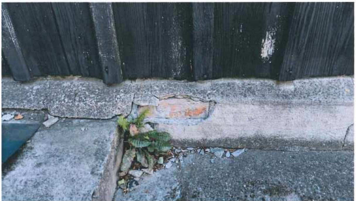
Fotografia 20. Widok części elewacji zachodniej kościoła w Umieniu – zmuszałe końcówki deskowań, widoczne wykwyty i zagrzybienie
