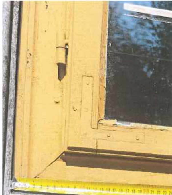
Rysunek 12. Widoczne okucia, zawiasy i ościeże. Rama okna szerokości ok 8 cm z wklęsłym zewnętrznym profilem. Widoczne frezowanie ramy okiennej.
