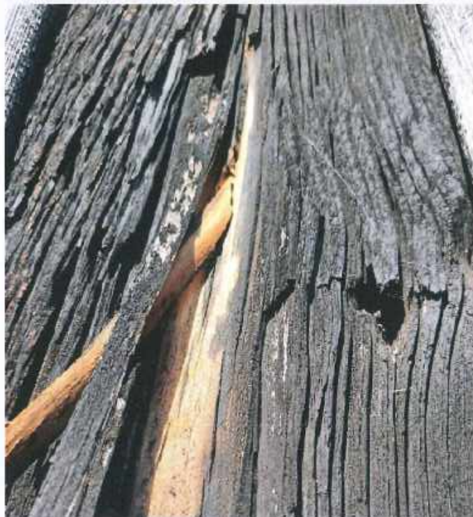
Fotografia 24. Widok najbardziej zdegradowanych desek stanowiących oblicówkę kościoła w Umieniu – deski rozwarstwiły się na połączeniach włókien.
