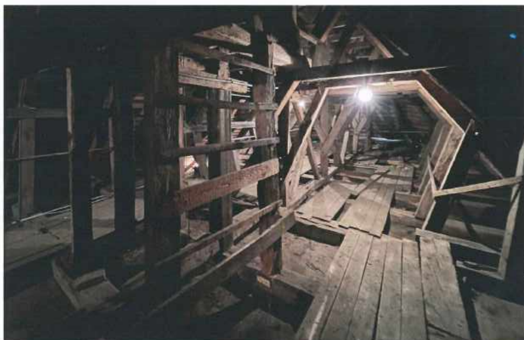
Fotografia 11. Widok na elementy konstrukcyjne belek stropowych nad korpusem kościoła – konstrukcja sygnaturki oparta wprost na dwóch belkach stropowych, widoczne ugięcie i próby wyparcia konstrukcji sygnaturki. Brak podwaliny. Widoczna degradacja elementów konstrukcyjnych po wykonaniu sygnaturki.
