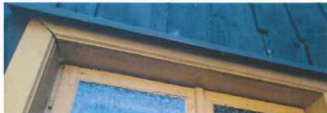
Rysunek 4. Okapnik okna O1 – z blachy powlekanej, specyficzny na tle pozostałej stolarki. Element wtórny.
