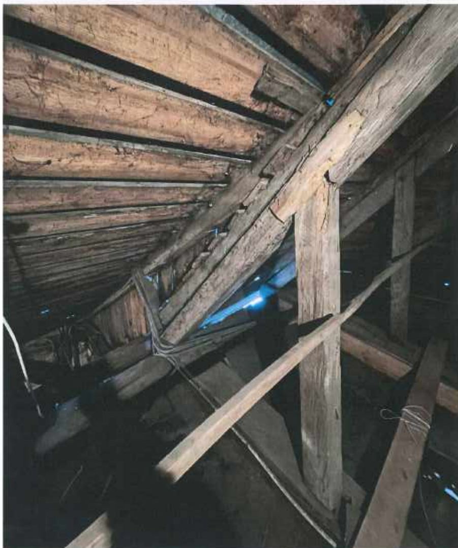
Fotografia 5. Krokiew (nad zakrytą) stan drewna zły, widoczne naprawy, element na całej długości rozwarstwiony (pęknięty) - nie spełnia swojej funkcji.
