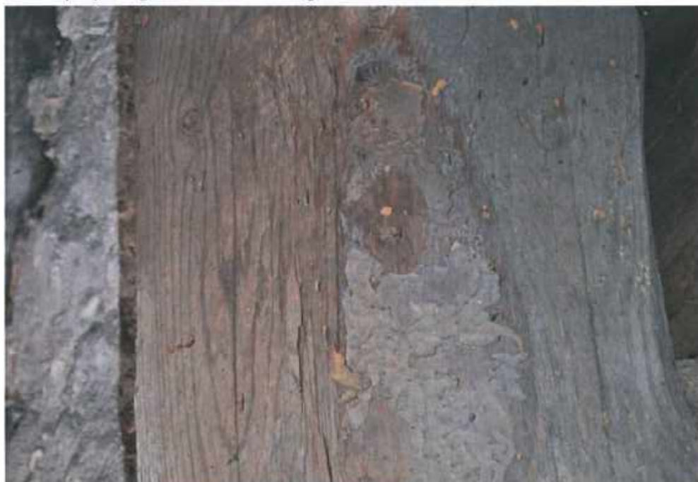
Fotografia 11. Widoczne żerowisko kołatka
