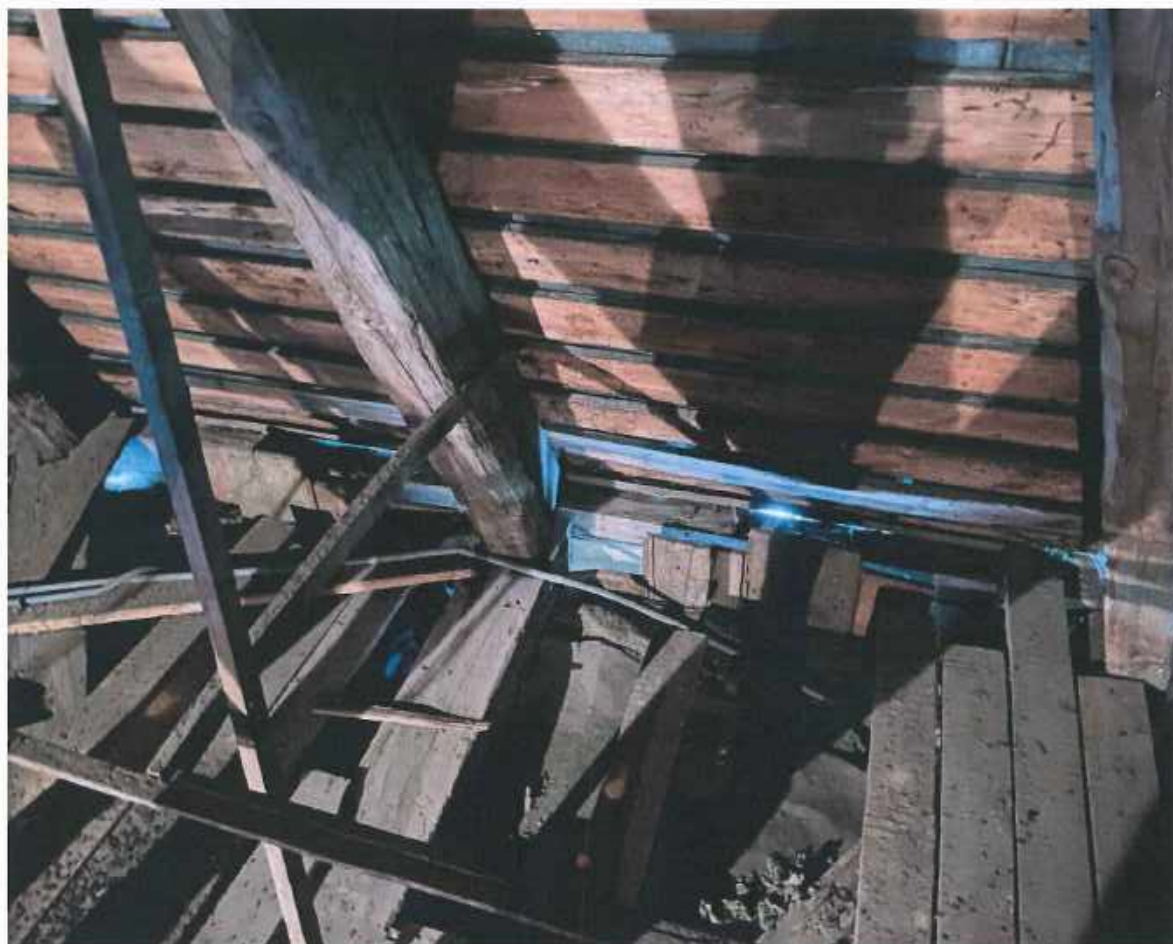
Fotografia 7. Widok na elementy konstrukcyjne belek stropowych w części prezbiterium – widoczny załamany ślepy pułap na końcówkach belek widoczne przegnicia w miejscu spotkania belki stropowej z krokwią
