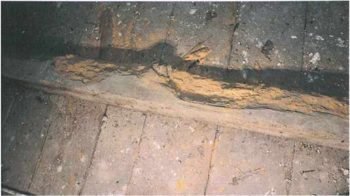
Fotografia 8. Podwalina dolna - element w znacznym stopniu spróchniały, widoczne czynne żerowisko spuszczela pospolitego
