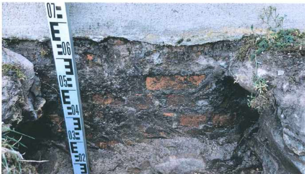
Fotografia 4. Odkrywka fundamentów nr 2 przy kaplicy bocznej od strony wejścia głównego. Widoczne zawilgocenie cegieł, brak izolacji poziomej i pionowej.
