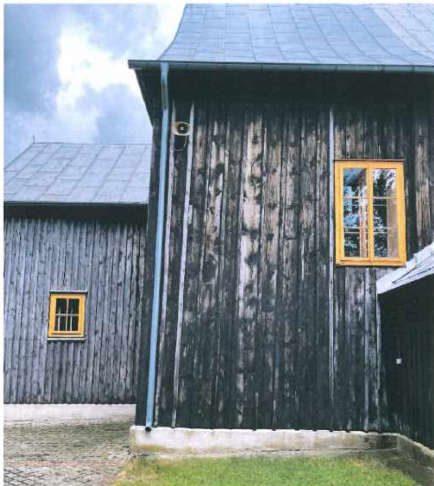
Fotografia 6. Widok elewacji południowo zachodniej – widoczne zmurszałe końcówki ołaceń ścian zewnętrznych
