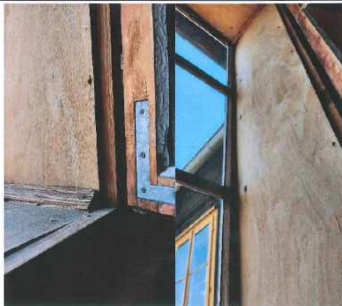
Rysunek 9. Widoczna konstrukcja kołnierza okna O2 pomiędzy skrzydłami oraz konstrukcja skrzydła wewnętrznego.
